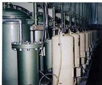
P社 27/54型 20台稼働中
